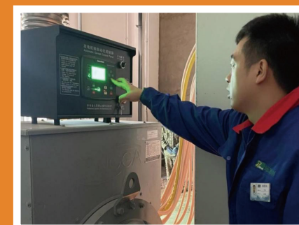
发电机组运正式调试运行
